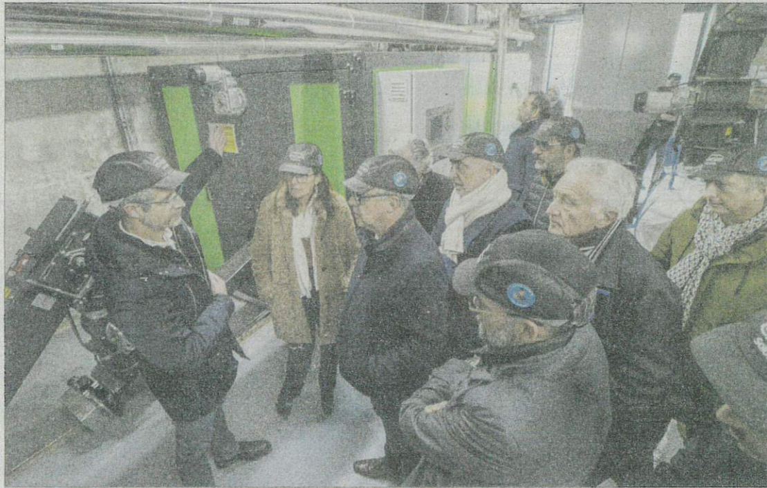
740 tonnes de biomasse locale seront valorisées chaque année.
